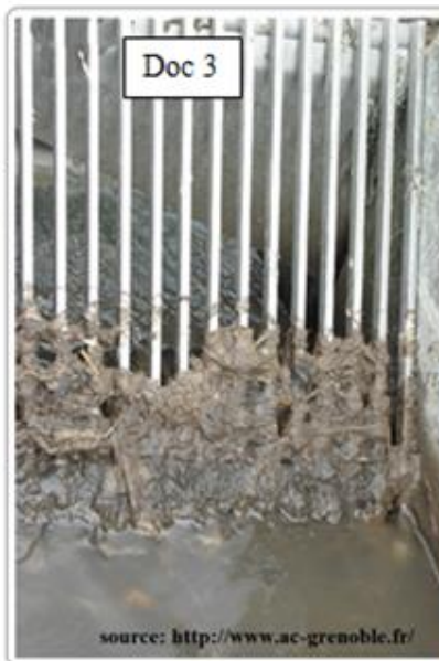
Dégrilleur de station d'épuration: espacement des barreaux = 50mm
